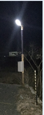
駐車場への設置
